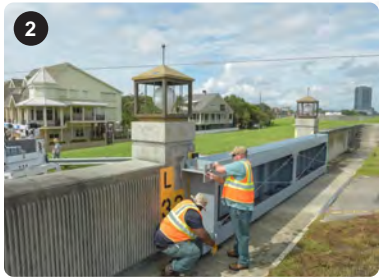
Compuertas para inundaciones Metairie/New Orleans, LA
