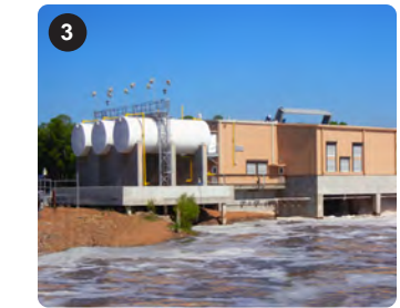
Nueva estación de bombeo Ascension Parish, LA
