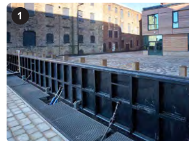
Barrera para inundaciones rebatible Susquehanna River, PA
